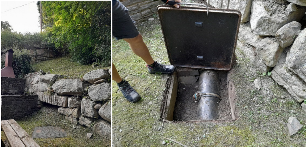
Fotografies 1 i 2. Vista de la primera arqueta, pròxima al límit superior de la parcel·la, on únicament s'observa la canonada de fundició dúctil de 250 mm de diàmetre.
